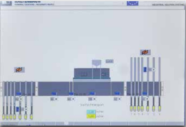
Пульт управления роликовым конвейером
