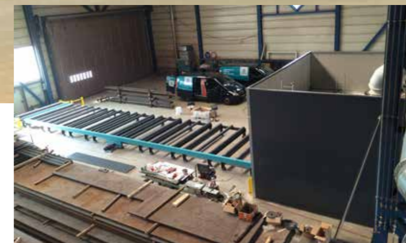
Lärmschutzkabine um die Maschine.
