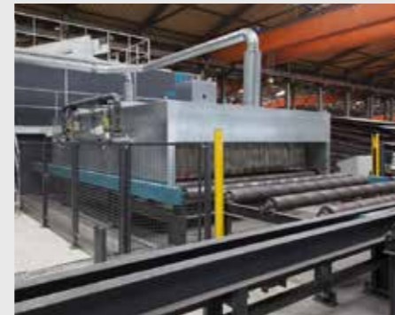
Energiesparende und vollisolierte Vorwärmöfen gewährleisten die richtige Materialtemperatur vor der Lackierung.
