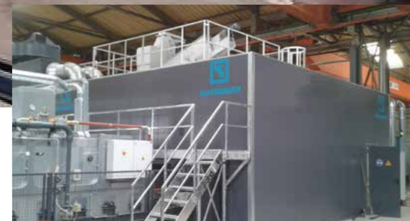
Lärmschutzkabine um die Strahlanlage.
